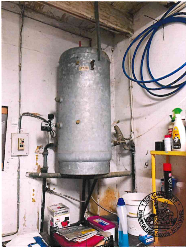
4. Ballon eau forage
