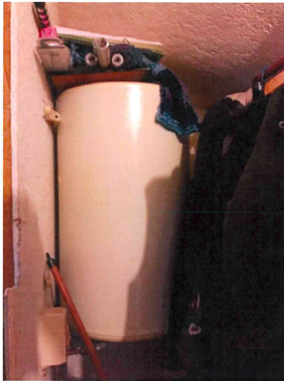
4. Cumulus électrique sous la montée d'escaliers
